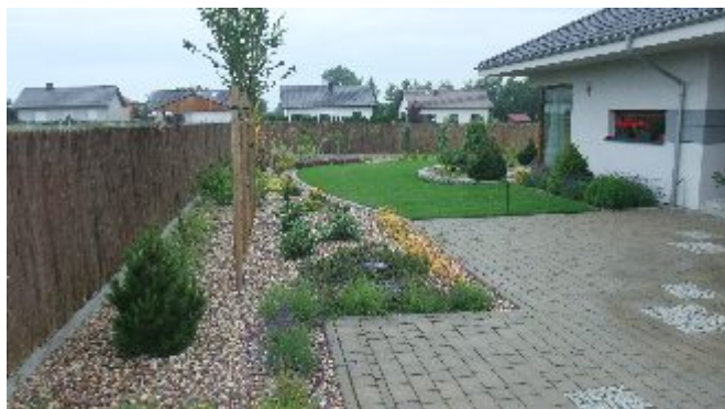
Oczyszczalnia SBR Primo+ wkomponowana w kruszywo
